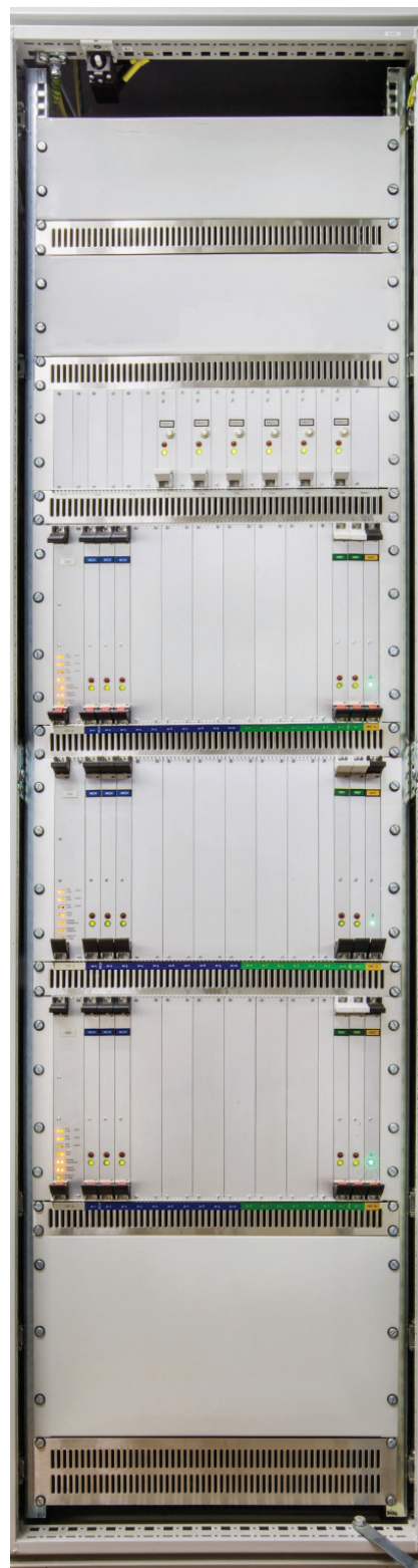
Рисунок №6. Шкаф УСО
