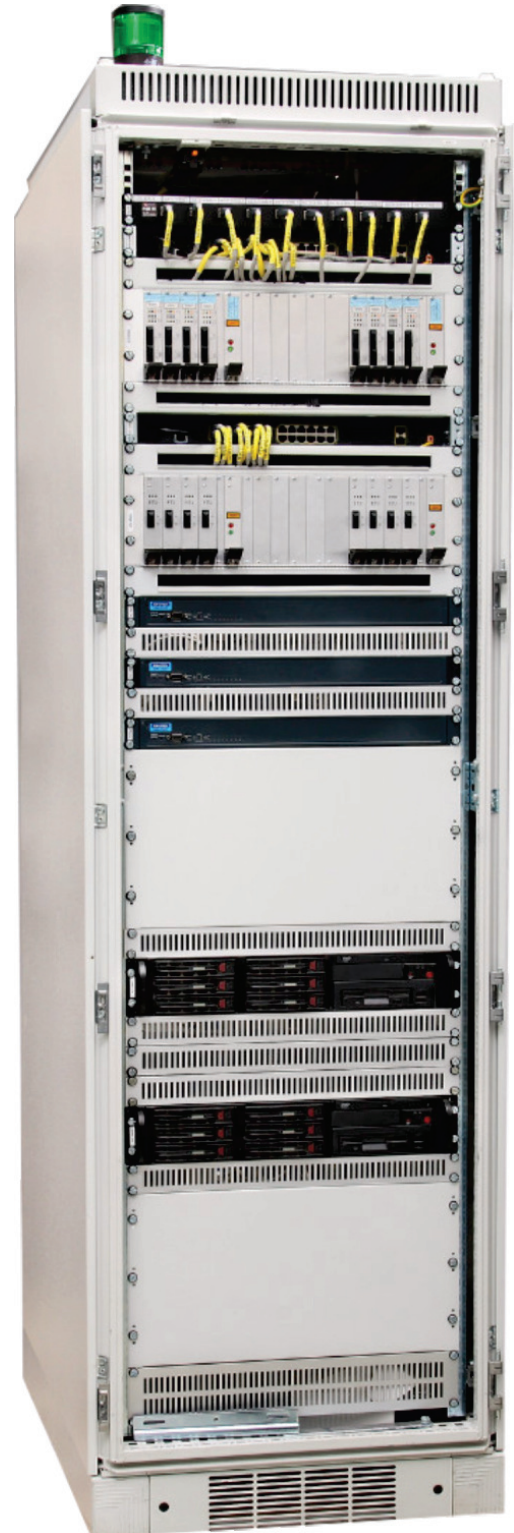
Рисунок №8. Шкаф КСУ РА
