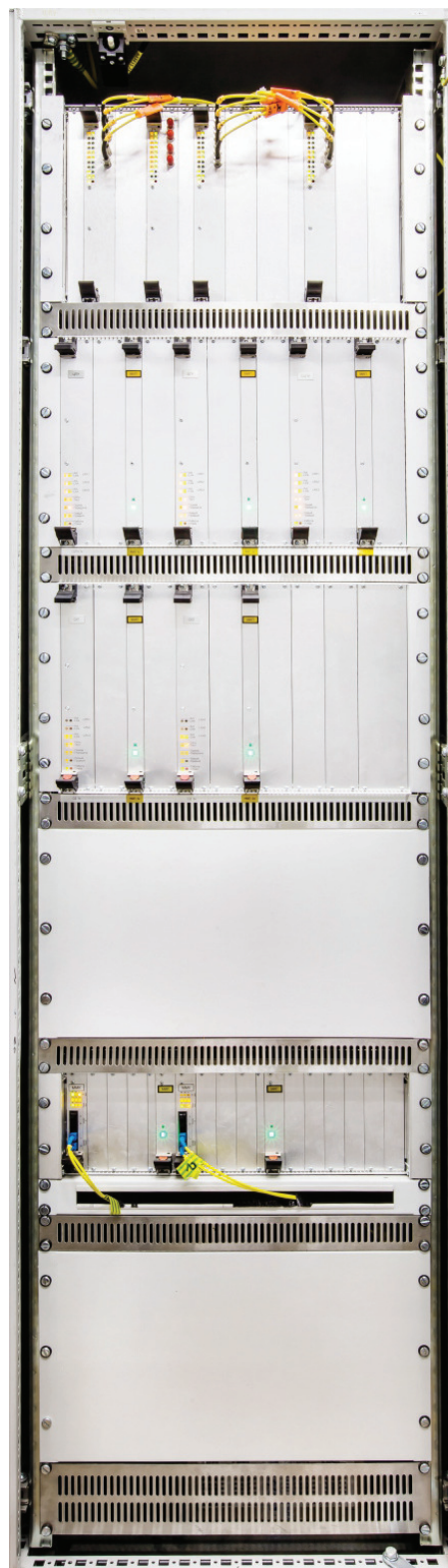
Рисунок №5. Шкаф ЦПУ
